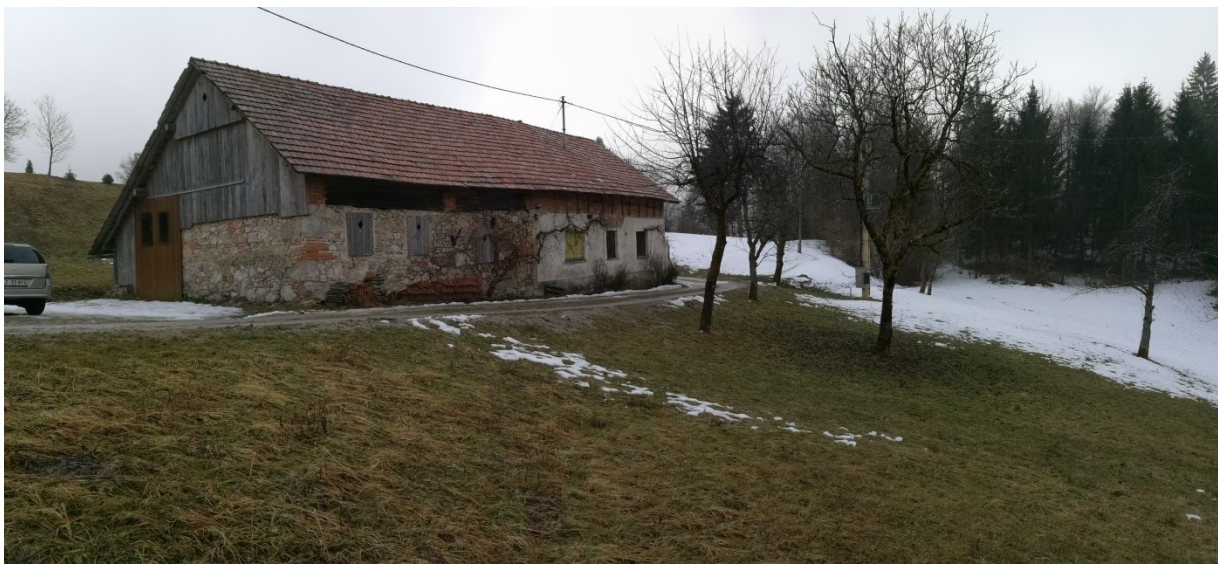
Prikaz dejanskega stanja – pogled na območje LP iz zahodne strani na dovozno pot in obstoječi objekt
